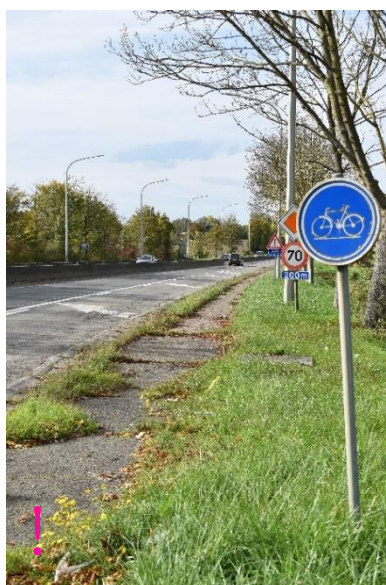
Piste cyclable séparée en mauvais état et mal entretenue N90
