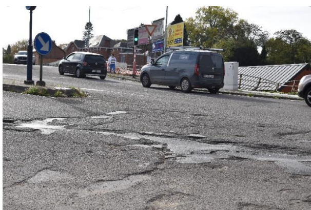
Revêtement en mauvais état rue du Dr Romedenne
