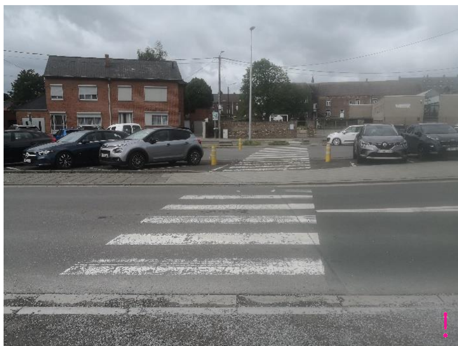
Auvelais – rue Pont-Ste-Maxence : revêtements hétérogènes, traversée en mauvais état, manque d'aménagements PMR
