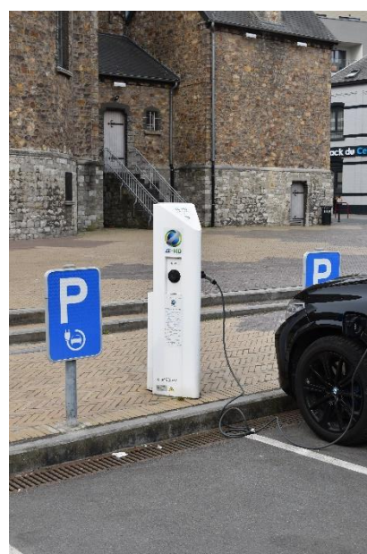
Stationnement réservé pour recharge électrique (Parking derrière la Grand'Place d'Auvelais)
