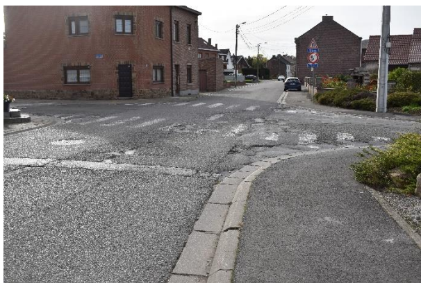
Revêtement en mauvais état rue Haut Baty
